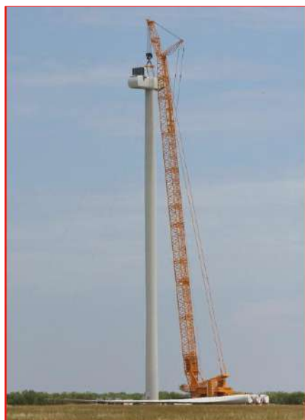
Figura 2-27 Exemplo de instalação de turbina eólica
